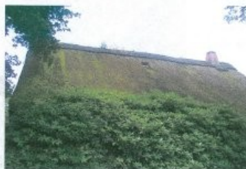
Vermoostes Dach mit Bewuchs auf der Heidefirst
