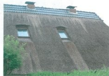
Kupferabdeckung unter dem Fenster. Erkennbare Wirkung der Absonderungen aus dem Kupferblech.
